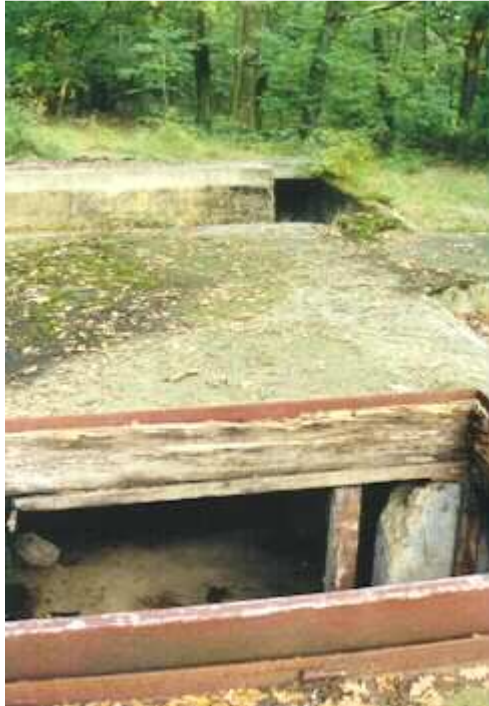
Unterirdisches Pumpenhaus beim Löschbecken
